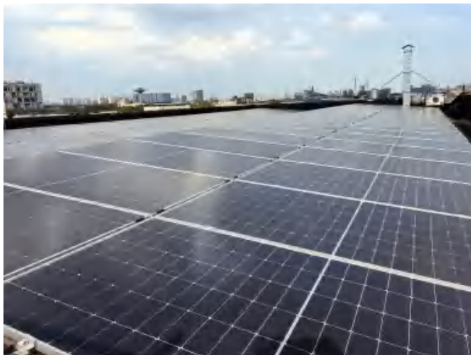
光伏发电项目
